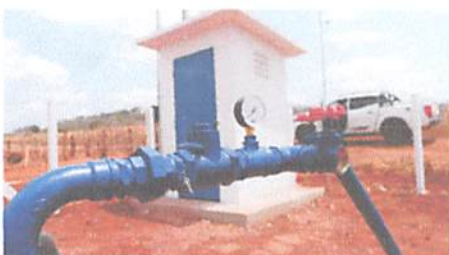
O Governo do Estado investe na instalação de SAA em vários municípios maranhenses
