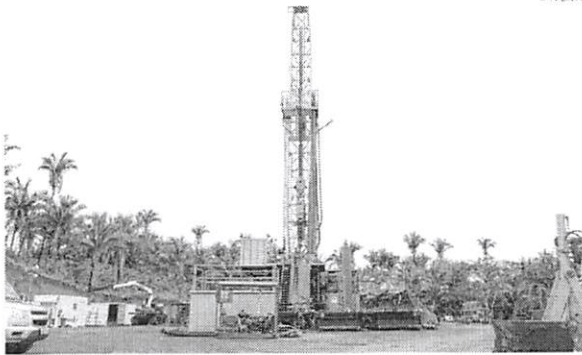
Sonda de perfuração de poço em campo exploratório da Eneva na Bacia do Parnaíba, no Maranhão
